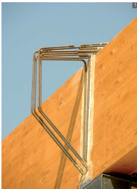
Foto 5, 6, 2 e 3 - Formazione del giunto che andrà a conseguire l'incastro tra la trave-arco e la trave-cassetta.
