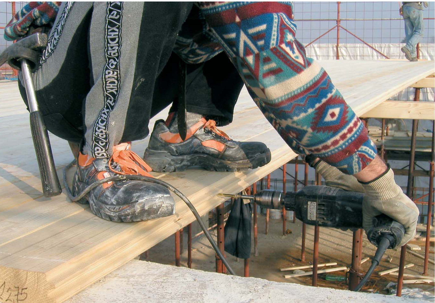
Particolari delle fasi di avvitamento per il serraggio tra loro delle aste in KVH a doppia maschiatura.
